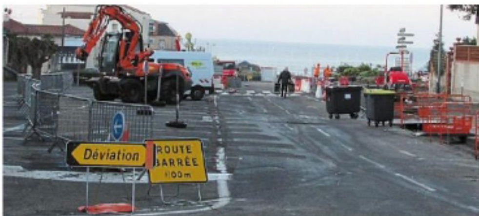
A Préfailles, les travaux de la place du village devraient être terminés pour les vacances de février. | CREDIT PHOTO : ARCHIVES OUEST FRANCE
